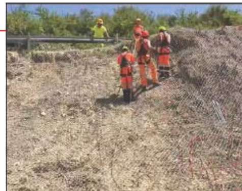
I lavori per la frana
